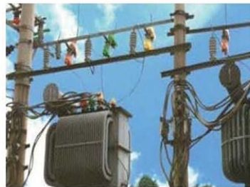
变压器进出线保护罩和跌落式熔断器保护罩在变电路路中的实际应用
